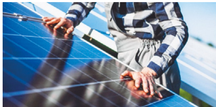
Die Produktion von Solarstrom auf dem eigenen Dach lohnt sich finanziell und macht von Energieimporten unabhängiger.
