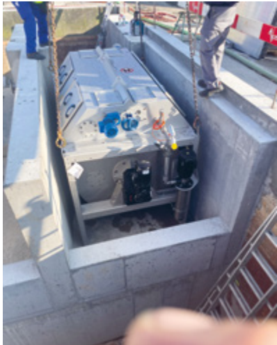
Einsetzen der Trommelsiebe zur maschinellen Vorklärung.
