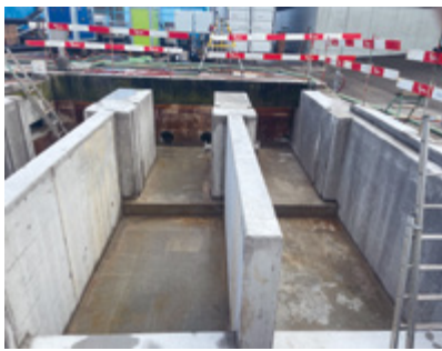
Vorbetonierter Kanal zur Aufnahme der Trommelsiebe.
